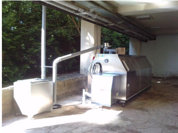
Εικόνα 2: Η εγκατάσταση κομποστοποίησης στην Πανεπιστημιούπολη Ιωαννίνων
