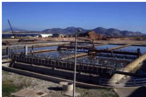
Φωτογραφία 3. Κέντρο Επεξεργασίας Λυμάτων (Δεξαμενή Πρωτοβάθμιας Καθίζησης)
